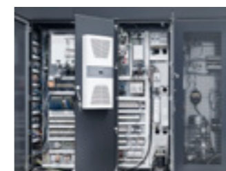
Leicht zugänglicher, klimatisierter Schaltschrank.
