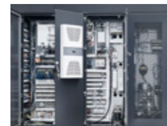
Armario eléctrico climatizado de fácil acceso.
