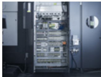
Leicht zugänglicher, klimatisierter Schaltschrank.
