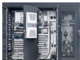
Armario eléctrico climatizado de fácil acceso.
