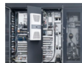
Armario eléctrico climatizado de fácil acceso.
