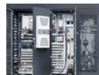
Armario eléctrico climatizado de fácil acceso.
